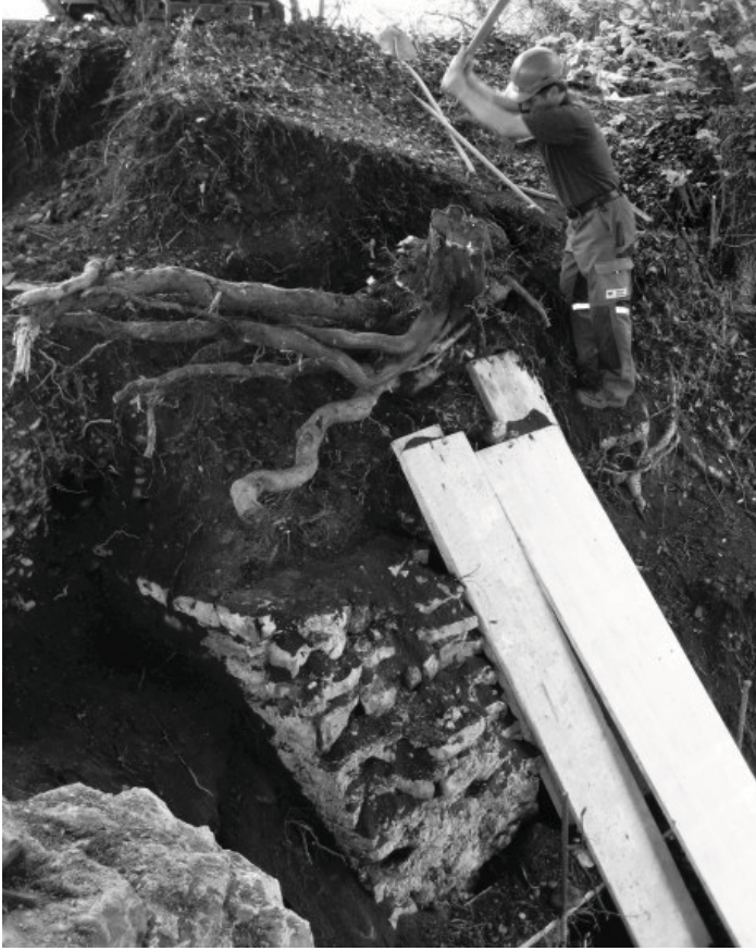
Der starke Baum- und Pflanzenbewuchs auf der Mauerkrone des Stützpfeilers verursacht erhebliche Schäden am Mauerwerk. Die Wurzeln wurden deshalb durch Mladen Puklin von der Firma Fux AG radikal entfernt. (Foto Donald F. Offers)
