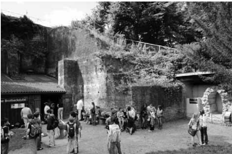
Die Gefahr von Steinschlag im Bereich der Backstube war für die Besucherinnen und Besucher zu gross. Deshalb musste der Stützpfeiler mit einem speziellen Containernetz überspannt werden. (Foto Donald F. Offers)
