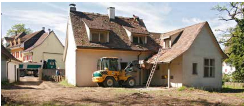
Abb. 22: Augst BL, Hauptstrasse 33 (Baubegleitung 2017.061). Der ehemalige Polizeiposten kurz vor dem Abriss. Blick von Norden.
