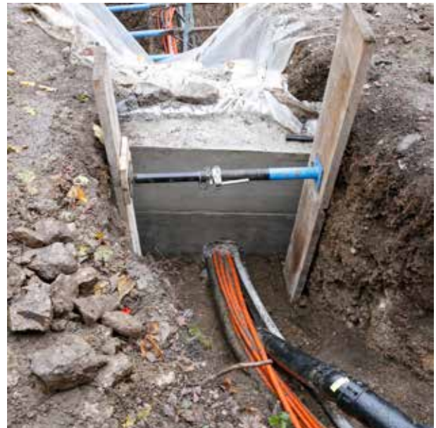
Abb. 49: Augst BL, Kanalisation Tierpark (Baubegleitung 2017.064). Innenseite der Stadtmauer mit angegossener temporärer Betonstützmauer zur Verankerung der Kernbohrmaschine. Blick von Westen.
