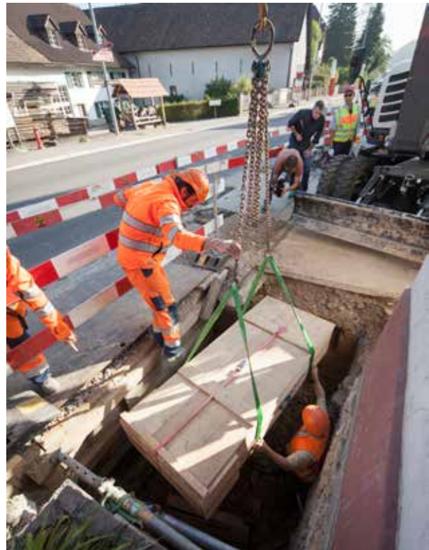
Abb. 21: Augst BL, Rheinstrasse (Grabung 2016.055). Der Block mit dem Bleisarg wird aus dem Graben vor dem Restaurant Salmeck gehoben.
