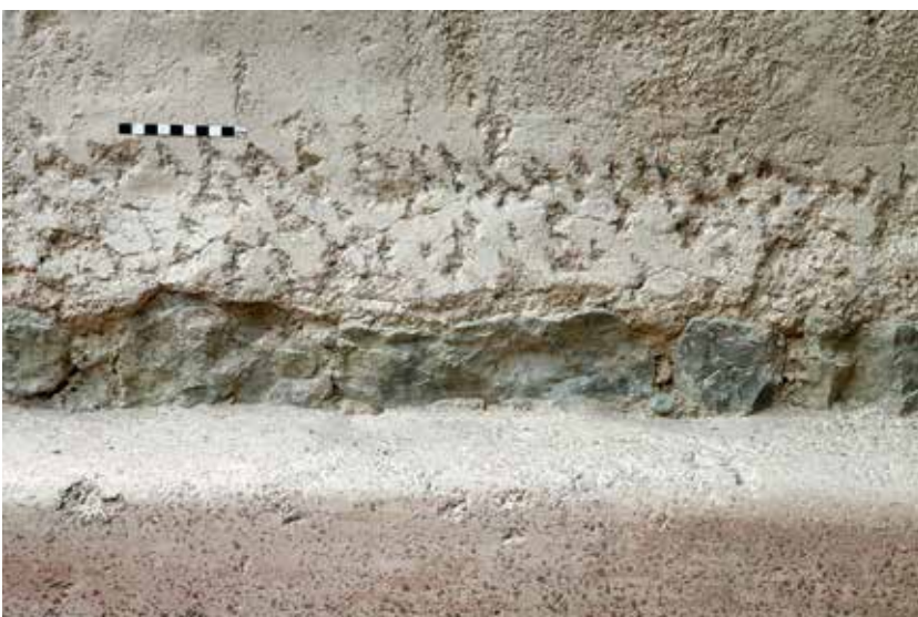
Abb. 41: Kaiseraugst AG, Nachuntersuchungen Schmidmatt (Dokumentation 2016.005). Haus 2, Raum 10: Detail von Mauer MR 29 mit gepickter Putzoberfläche oberhalb des Beckens MR 74. Blick von Westen.
