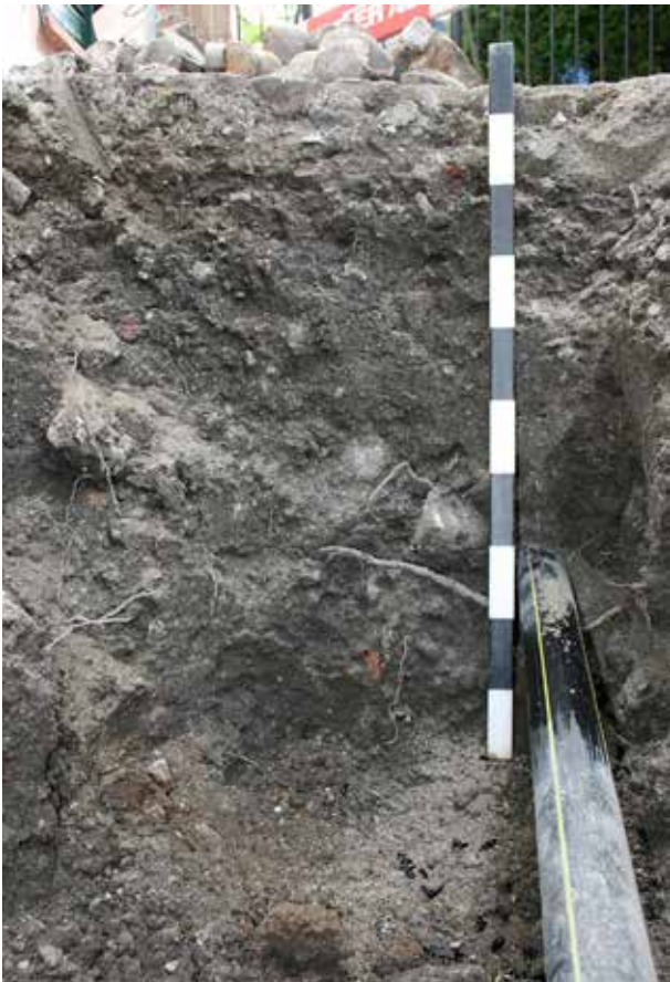
Abb. 86: Augst BL, Ehingerhof Gasleitungsleck (Baubegleitung 2016.067). Blick von Norden an die südliche Grabungsgrenze. Der Leitungsgraben zeichnet sich im dunkelbraunen Boden nicht ab.
