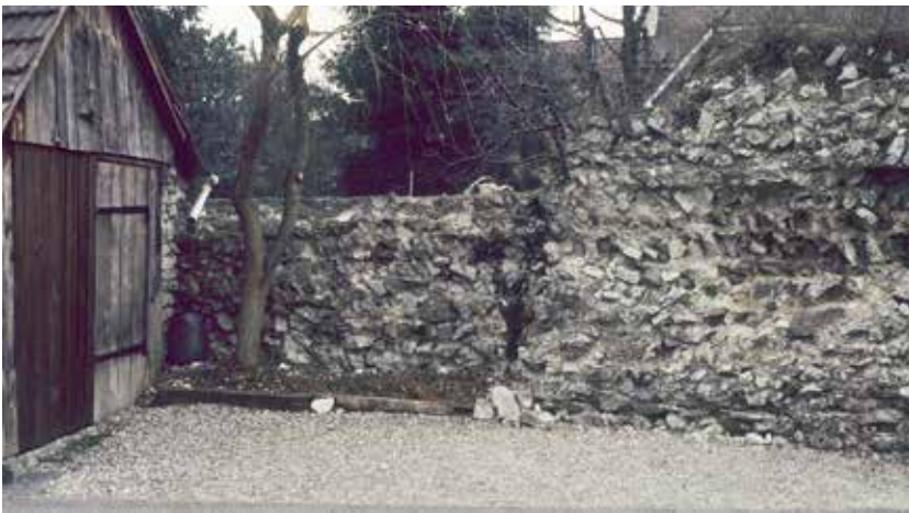
Abb. 57: Kaiseraugst AG, Sanierung Geräteschuppen Heidemurweg (Baubegleitung 2016.008). Situation im Jahr 1994. Einige lose Steine des Mauer kerns liegen am Mauerfuss. Blick von Süden.
