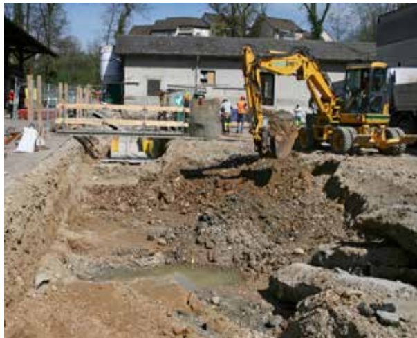
Abb. 35: Augst BL, Werkhof E. Frey AG (Grabung 2015.054). Grossflächige Aushubarbeiten im Mittelteil der geplanten Werkhalle. Das abgebaute Material stammt von Planierungen im Zusammenhang mit dem Ausbau des Werkplatzes. Von Südwesten.
