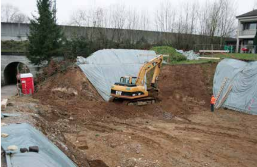
Abb. 22: Augst BL, Hausmatt (Grabung 2015.053). Aushubarbeiten am östlichen Baugrubenrand. Im Hintergrund die Schallschutzwand der SBB-Linie, links die tunnelförmige Unterführung, durch die der Hausmattweg an die Ergolz führt. Von Nordwesten.
