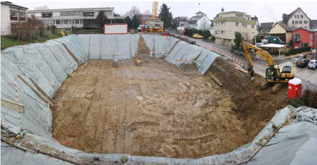
Abb. 24: Augst BL, Hausmatt (Grabung 2015.053). Die erweiterte Baugrube nach den zusätzlichen Aushubarbeiten im Februar 2015. Von Osten.
