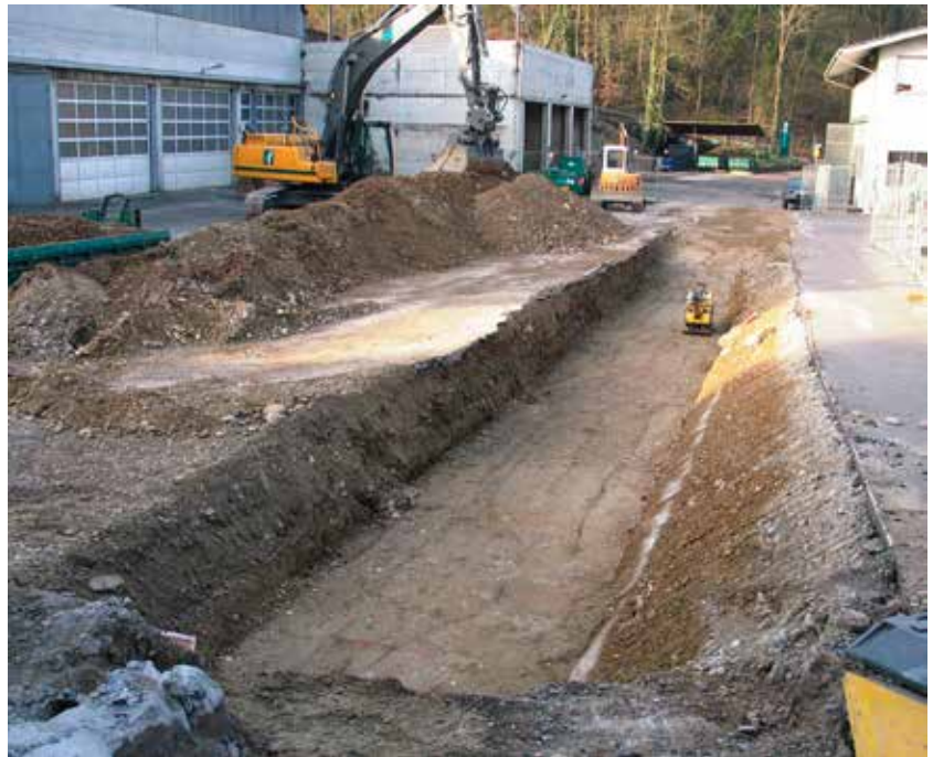
Abb. 32: Augst BL, Werkhof E. Frey AG (Grabung 2015.054). Aushub für das nordwestliche Fundament der geplanten Werkhalle. Von Nordosten.
