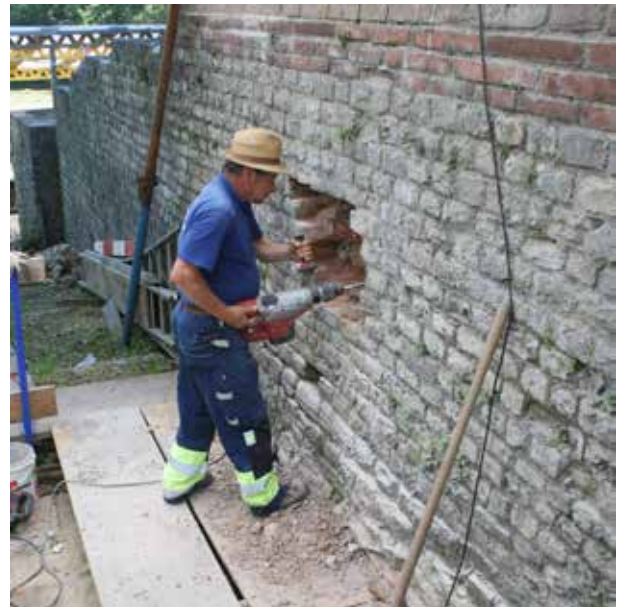
Abb. 59: Augst BL, Basilica-Stützmauern (Grabung 2015.057). Im deutlich als 1941 wieder aufgebaut erkennbaren Teilstück von MR 14 wird eine Mauer-sondierung herausgebrochen. Damit sollte erstens abgeklärt werden, ob sich hinter der rechts zu sehenden Mauerschale noch Aufgehendes aus römischer Zeit verbirgt und zweitens, ob MR 14 tatsächlich auf die Nordkante von MR 8 gesetzt war, wie Befundbeobachtungen an der Innenseite nahelegten. Es erwies sich, dass MR 8 und MR 14 eine bauliche Einheit bilden (siehe Abb. 60). Von Südwesten.
