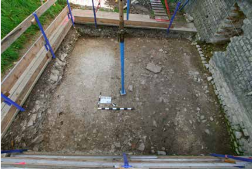
Abb. 61: Augst BL, Basilica-Stützmauern (Grabung 2015.057). In den ausserhalb des sogenannten Treppenhauses angelegten Grabungsfeldern waren nur wenige Abträge möglich. In Feld 7 konnte eine Zerstörungs- oder Verfallsschicht abgebaut werden. Im Profil links ist etwas vom Versturz von MR 14 (rechts im Bild) noch erhalten. Das jetzt freiliegende Niveau ist ungestört. Von Südwesten.
