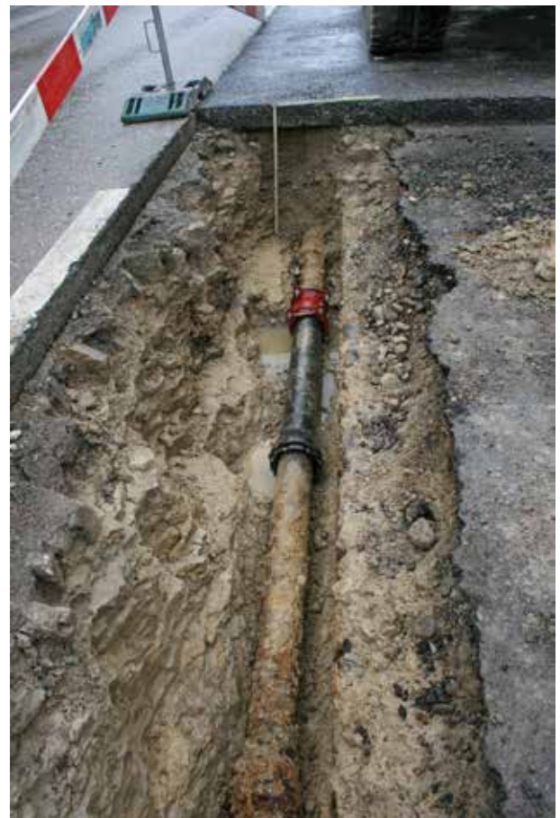
Abb. 53: Augst BL, Hauptstrasse Leitungsbrüche (Grabung 2013.066). Die vierte Bruchstelle (Feld 4) war schnell gefunden, da sie nur wenig weiter westlich lag als jene in Feld 3. Hinten oben die neu geteerte Fläche von Feld 3 (Abb. 52), wo die Leitung am Vortag repariert werden musste. Die Leitung liegt in einem aus dem anstehenden Fels heraus geschroteten Graben. Von Westen.
