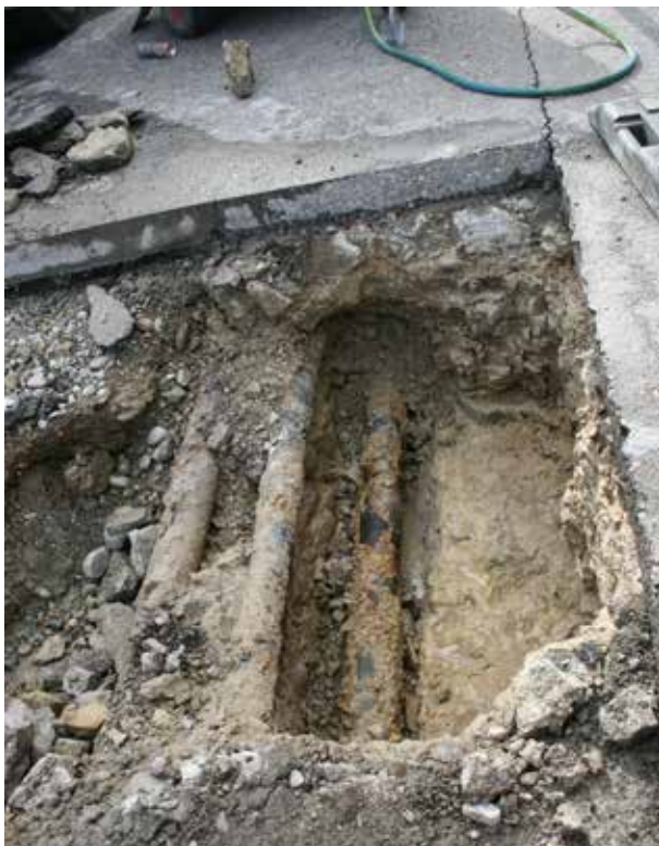
Abb. 52: Augst BL, Hauptstrasse Leitungsbrüche (Grabung 2013.066). In der Nordwestecke von Feld 3, fast in der Mitte der heutigen Strasse, kam die Leitung nach grossflächigem Nachgraben zum Vorschein (tiefstliegende Leitung in Bildmitte). Rechts von der Leitung der anstehende Fels. Von Osten.
