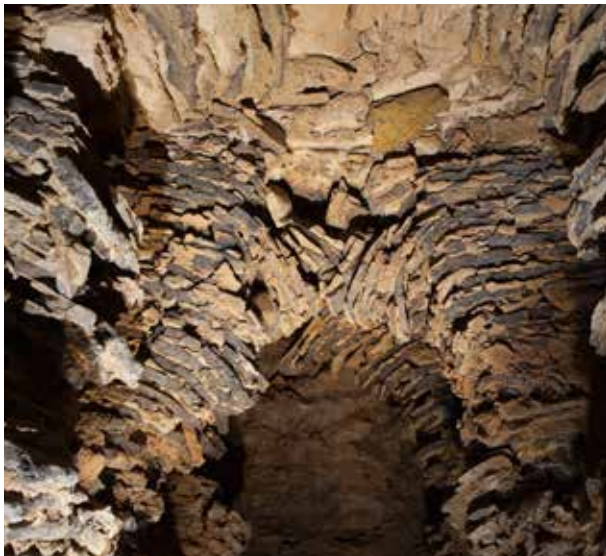
Abb. 15: Kaiseraugst AG, Liebrüti. Detailaufnahme der hitzegeschädigten Kragbögen 4 und 5 in der Heizkammer von Ofen ZK 50: Die Ziegel sind zusammengeschmolzen, verformt und paketweise abgesackt.
