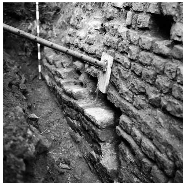
Abb. 62: Kaiseraugst/AG, St. Gallus (Grabung 1965.002). Pfarrgarten, Sondierung IV. Mittlerer Abschnitt MR 120 der Kastellmauer. Gegen Westen. Während der untere Teil der Mauer sich nicht verschob, kippte der obere Teil zum Rhein hin weg.
